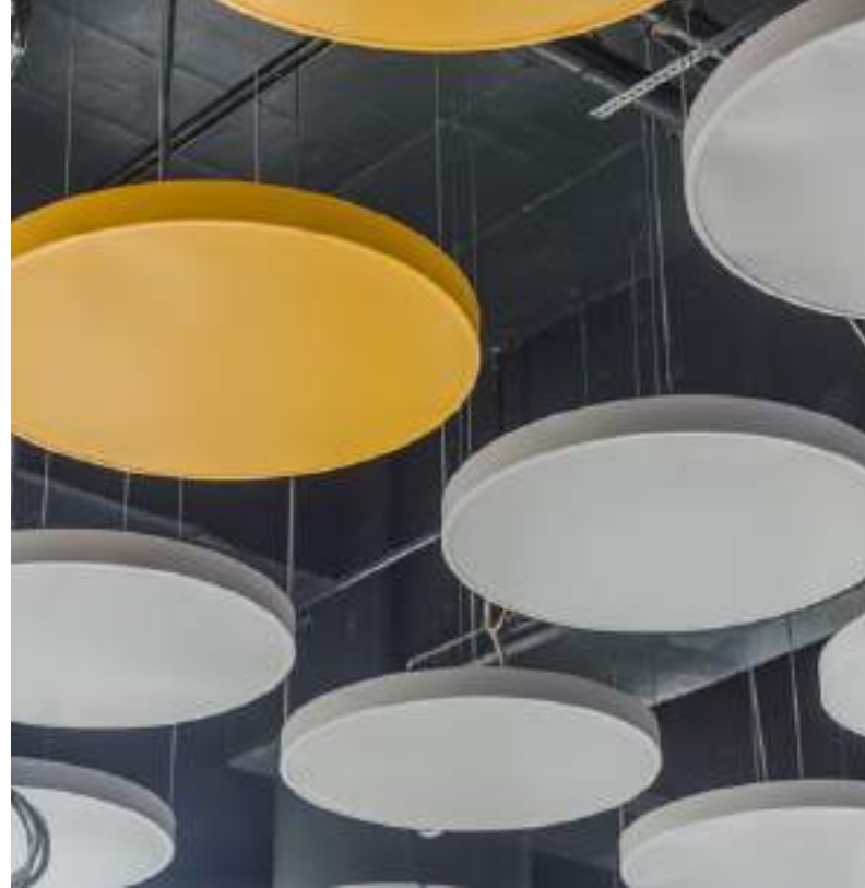
Ada Panel Sistem
